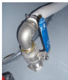
Vanne de décharge ouverte
