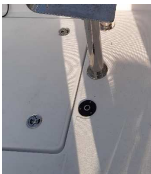
Orifice de décharge extincteur moteur sur plancher poste de barre
