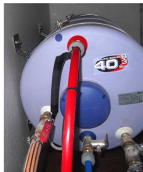
Chauffe-eau dans la soute moteur BD
