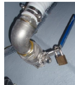
Vanne de décharge verrouillée
