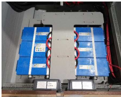
Parc batteries servitude et moteur sous couchette arrière Bd
